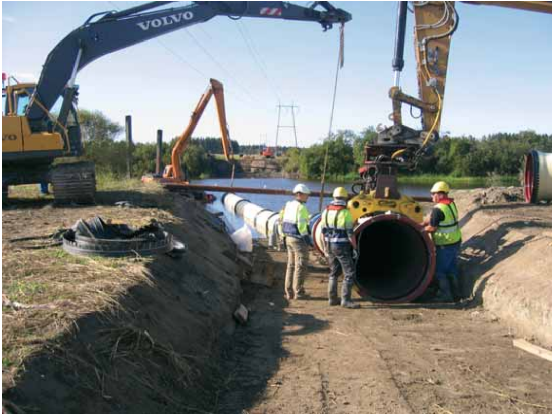
Kuva 17. Turun Seudun Vesi Oy:n 1 200 mm:n syöttöjohto rakenteilla vuonna 2009. (Kuva: Turun Seudun Vesi Oy.)
